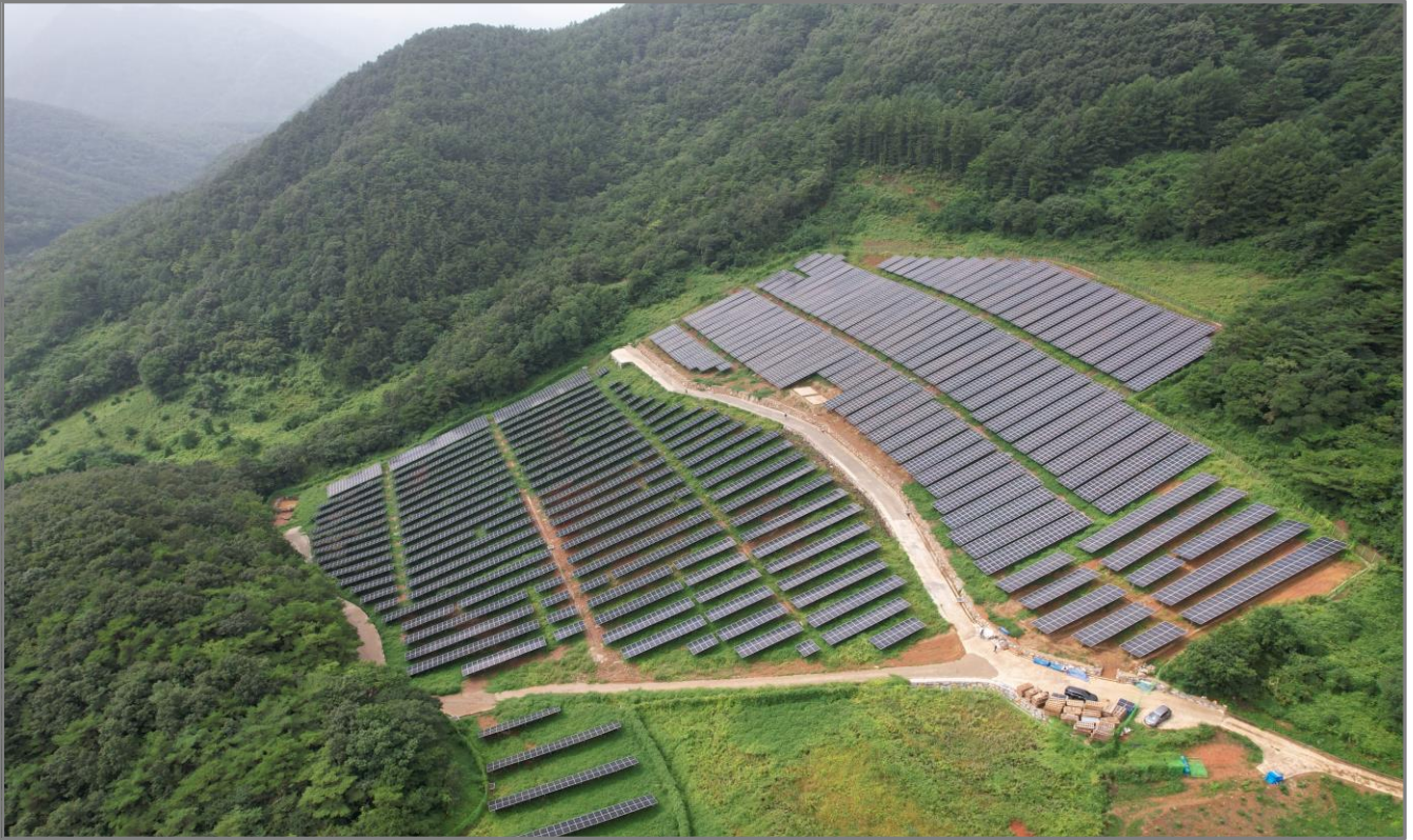
영월 태양광발전소 설치용량 : 4,200kW
