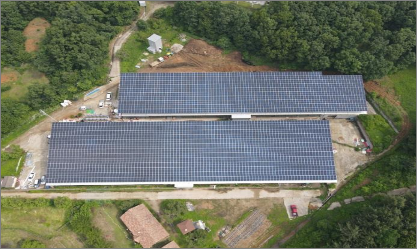
연천 태양광발전소 설치용량 : 1,200kW
