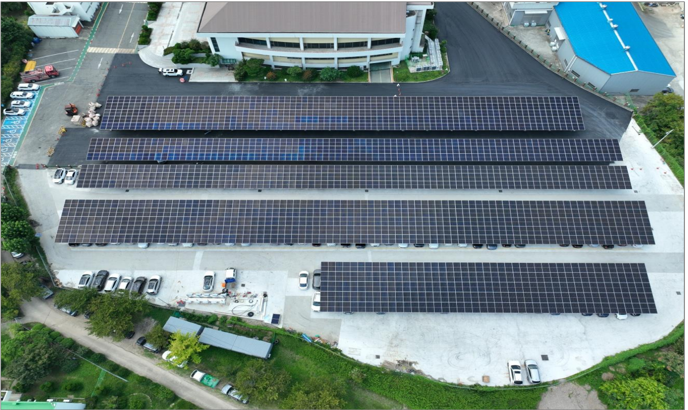
울산 태양광발전소 설치용량 : 1,000kW
